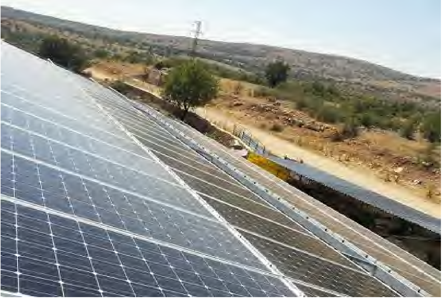
Ahmet KOÇ GES – Denizli 31,5kWp
